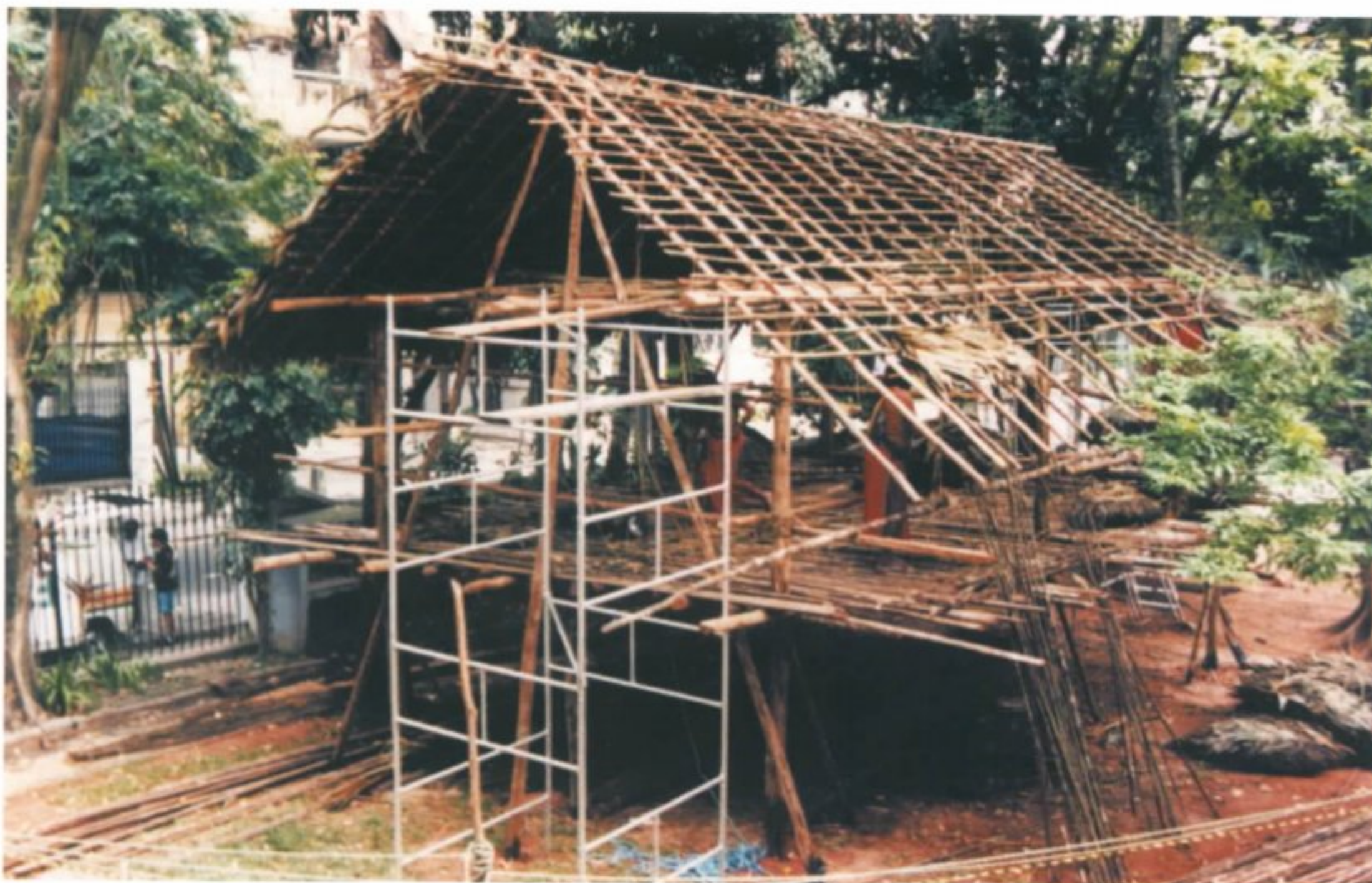
Uma das águas já foi inteiramente coberta. Um andaime foi colocado à disposição para agilizar a construção.
