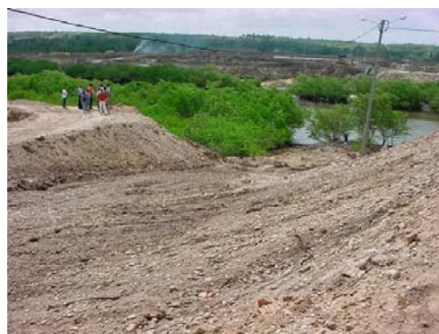
Taludes construídos em solo não compactado e sem cobertura vegetal; material pode ser facilmente carreado para o mangue ou para o rio.
