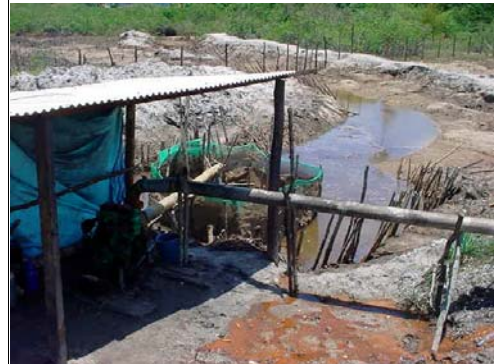
Casa de bombas sem nenhuma medida para evitar a contaminação do solo do manguezal pelo derramamento de óleos e combustíveis.
