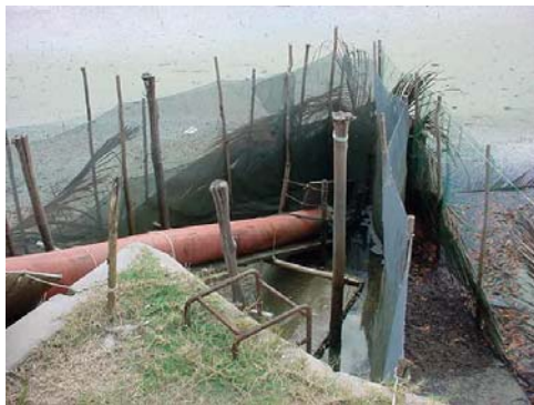
Sistema de captação, sem um método adequado para evitar que a fauna seja atingida.
