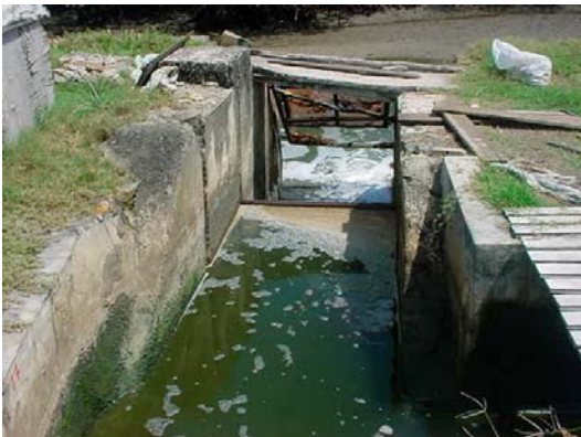
Descarte direto dos efluentes no manguezal, pode levar à contaminação das águas e da vegetação. Não há também um sistema eficiente para evitar fugas do camarão durante a despesca.
