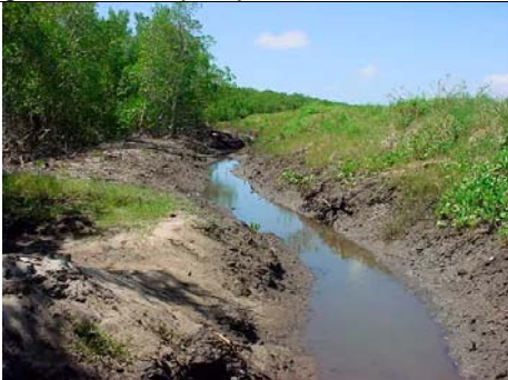
Construção de canal e talude contíguo ao manguezal, sem respeitar o recuo mínimo para evitar impactos negativos no ecossistema.
