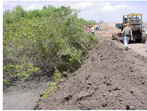
Manguezal afetado pela ampliação do empreendimento.
