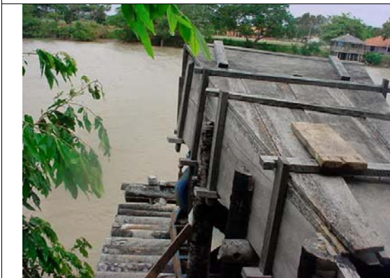
Precário estado da casa de bombas.
