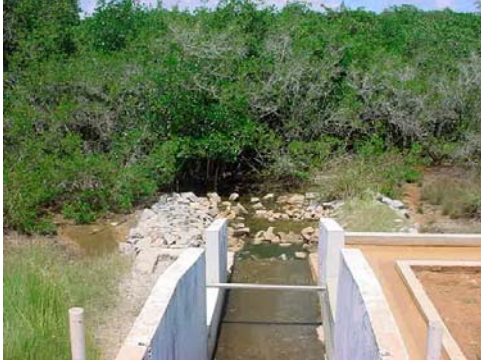
Descarte de efluentes diretamente no manguezal, sem qualquer tratamento.
