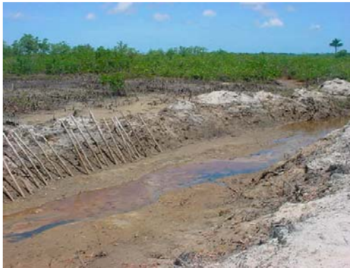
Detalhe do canal construído em área de preservação permanente.
