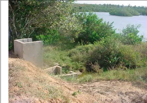
Ponto de descarga de efluentes diretamente na Lagoa do Portinho.
