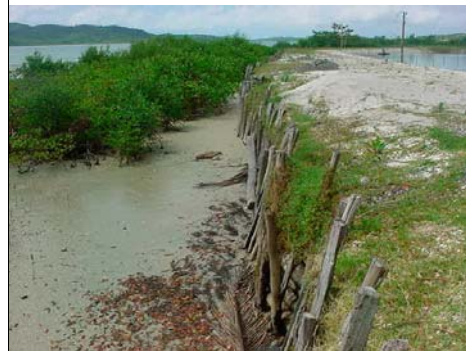
Talude sem distanciamento do manguezal, com precária sustentação.
