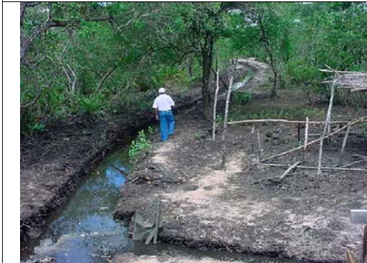
Construção de canais com supressão de manguezal, em desacordo à legislação ambiental. (foto do Relatório de março de 2003).
