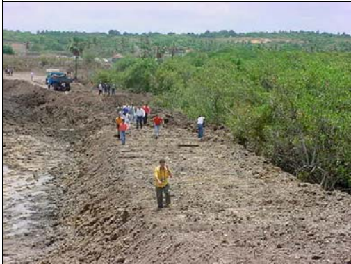
Vista parcial da área de manguezal que era aterrada no momento da vistoria.
