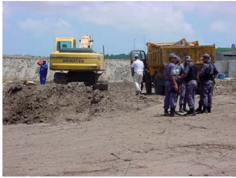
Ampliação de empreendimento sem a devida licença ambiental.
