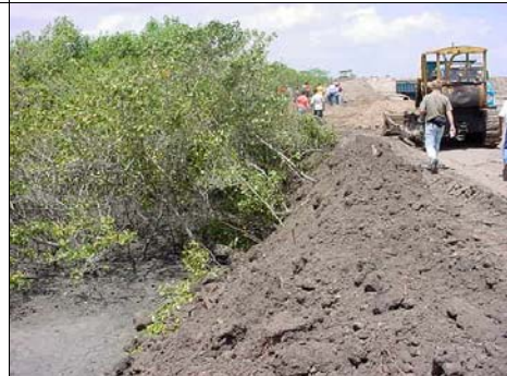
Supressão e aterro em área de manguezal. Esta infração ambiental mostrou-se ser uma ação constante no empreendimento.
