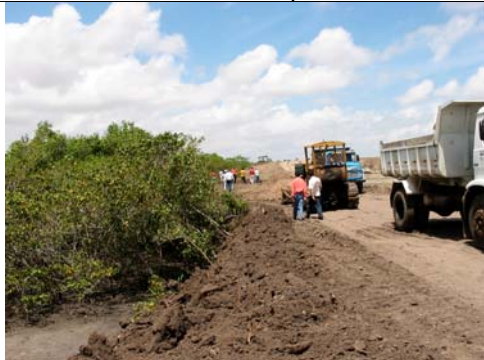
Talude sendo construído em APP de faixa do rio, soterrando vegetação de mangue.
