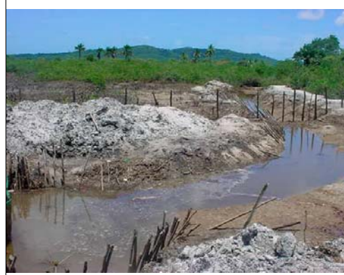
Canal construído para descarte de efluentes e captação da água. Nota-se que houve movimentação do solo do manguezal.
