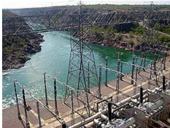
Rio São Francisco: geração de energia em Paulo Afonso-BA
