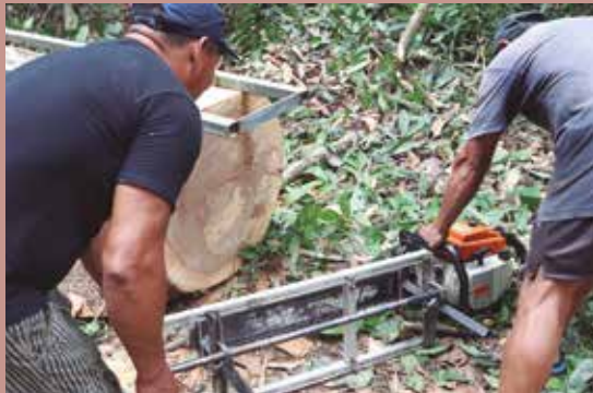
Figura 2 – Instalação da guia (gabarito) para retirada de tábuas na motosserra. O tamanho do sabre da motosserra deve ser longo o suficiente para o diâmetro da tora e a potência da máquina deve ser adequada.
