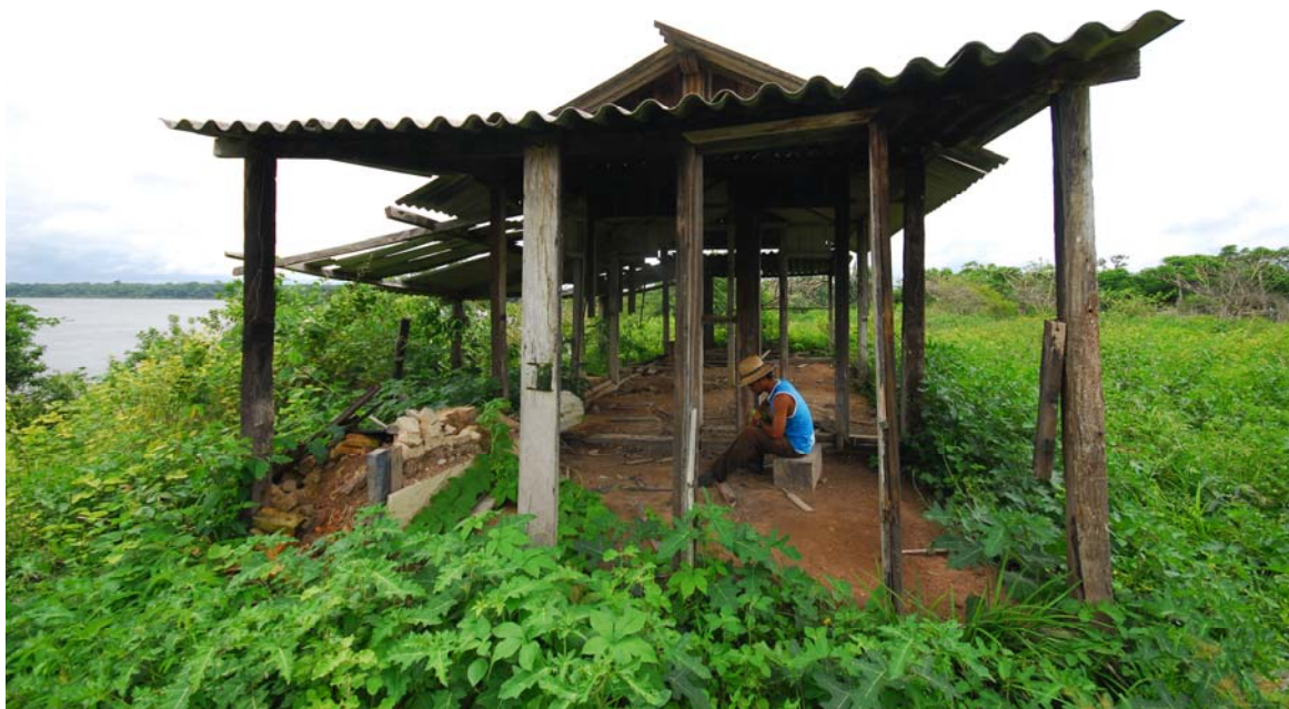
Ponto F – As diversas casas de empregados estão já caídas ou em vias de desabarem.
