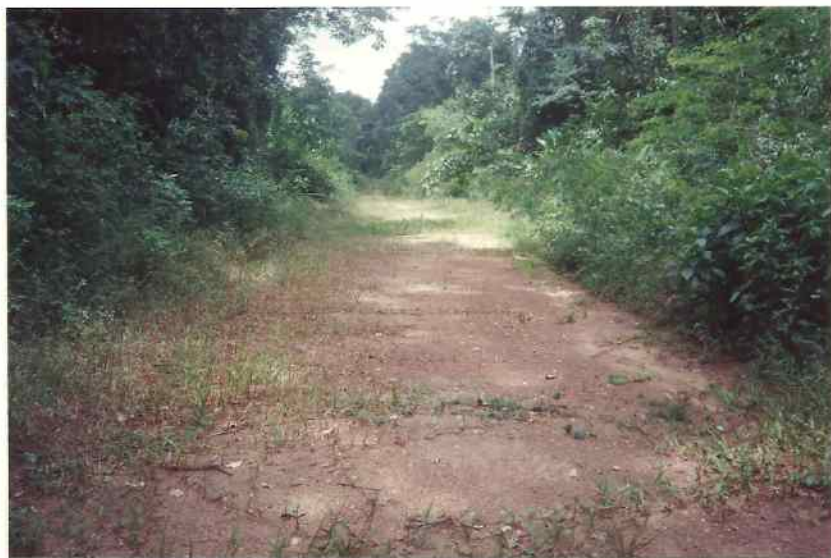
Condições da estrada Onde existe cascalho
