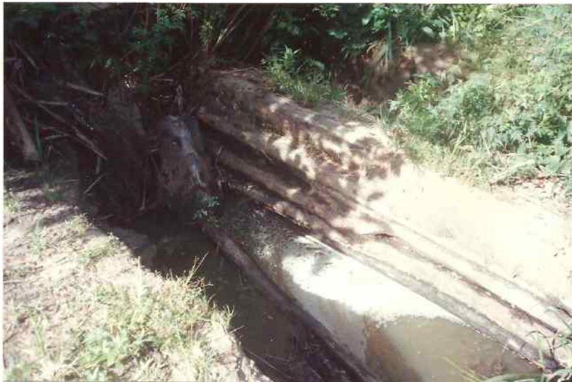
Situação de um bueiro com uma cratera muito grande, estrada cortada.
