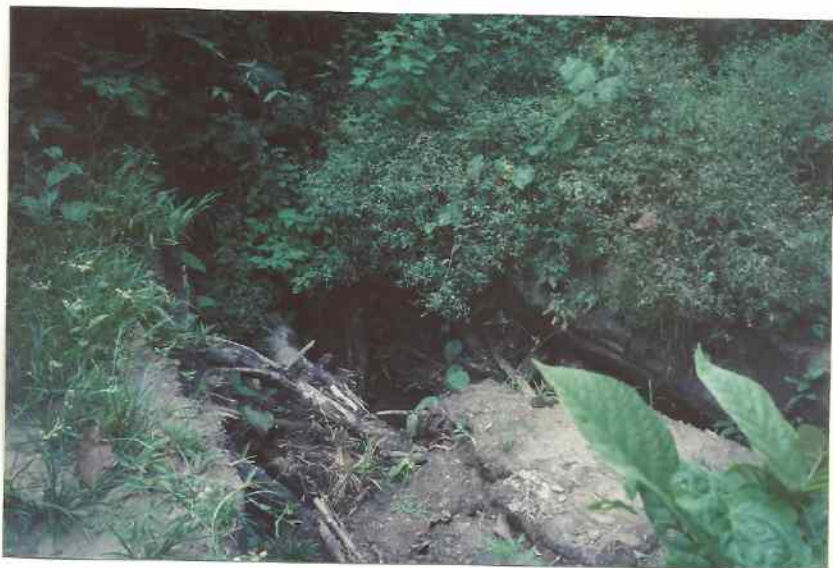
Situação de um bueiro e estrada cortada por erosão.
