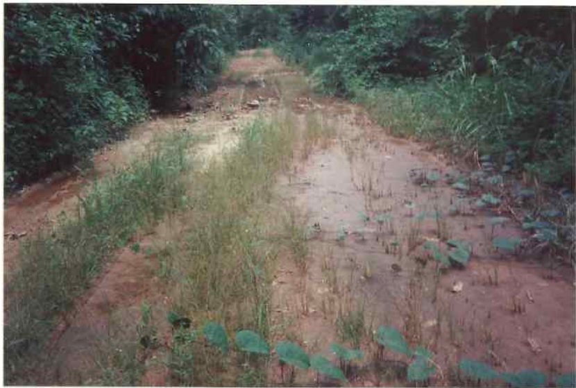
Trecho da estrada mostrando local de atoleiro
