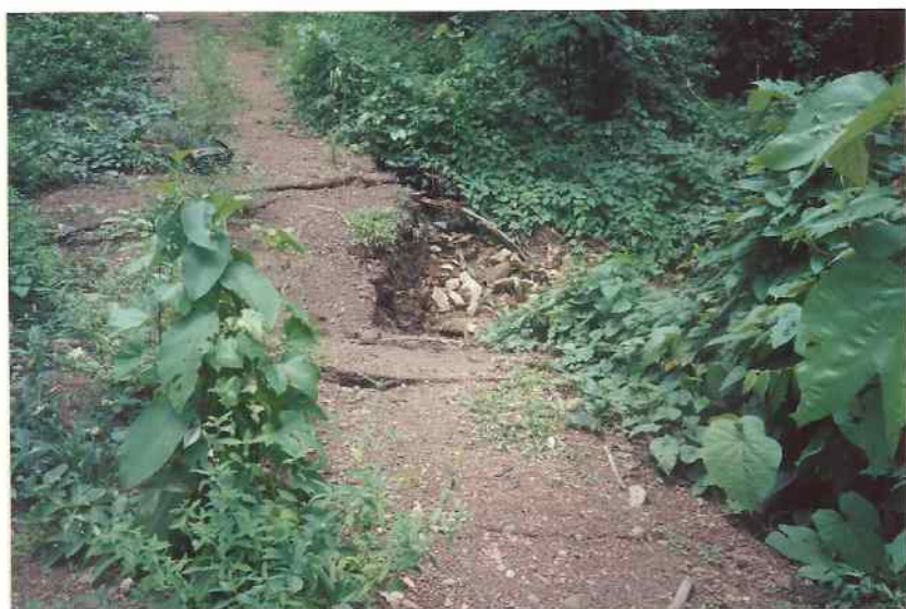
Trecho da estrada cedendo.
