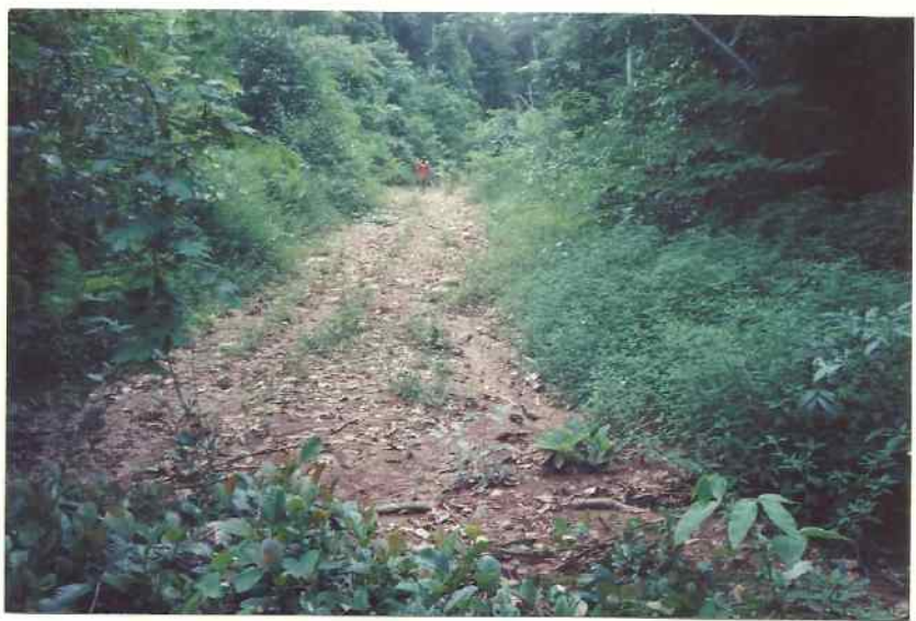
Trecho da estrada na serpa muita pedra solta
