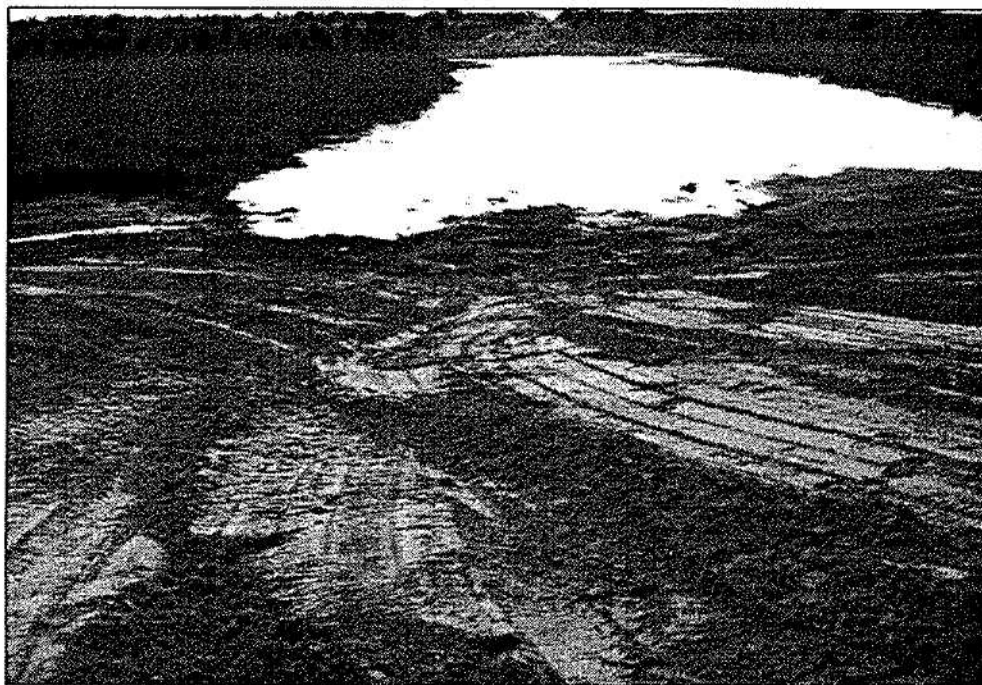
Las medidas inadecuadas de mitigación ocasionaron considerables daños en el lugar donde el gasoducto cruza el río San Miguel (Bolivia).
