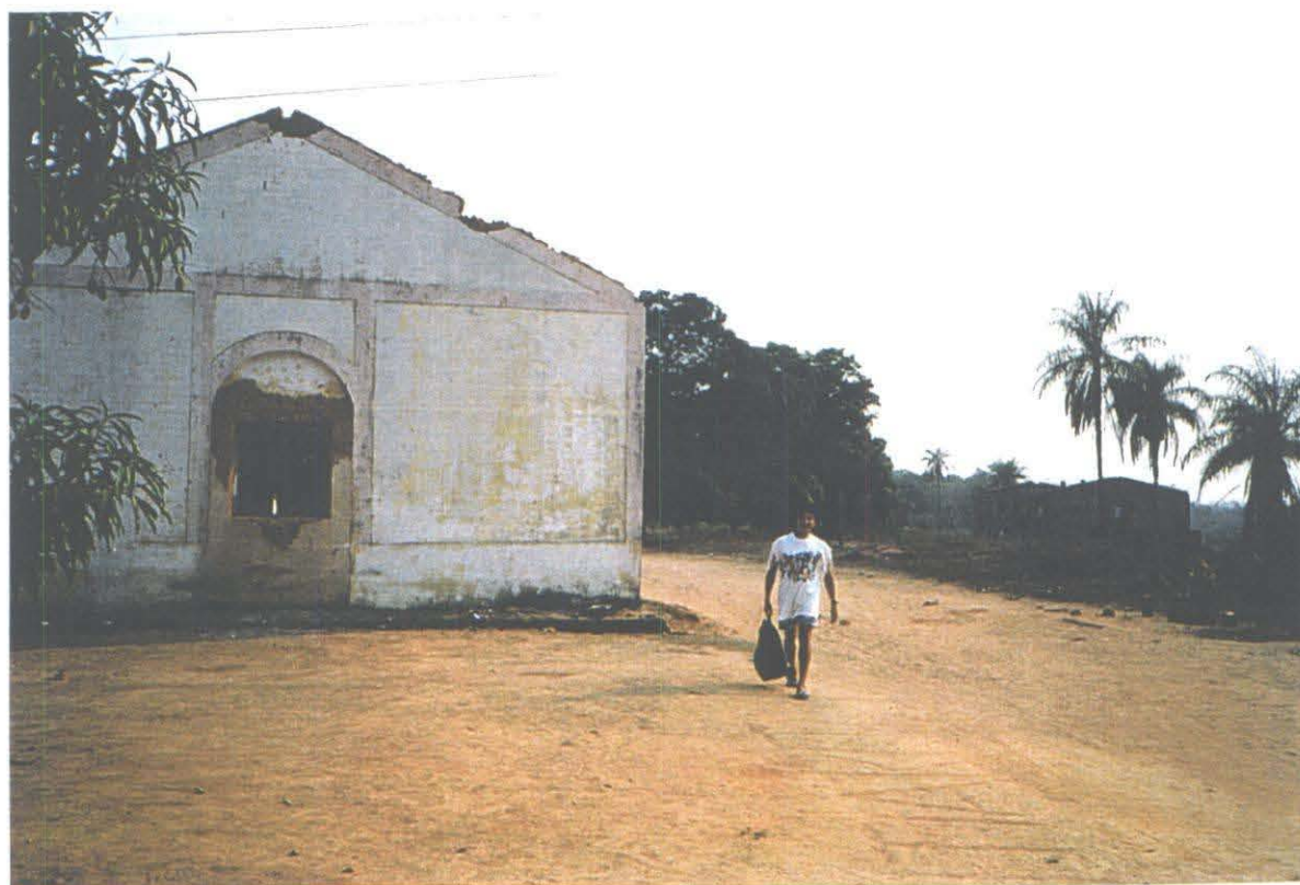
Ruína da Igreja de Utiariti
